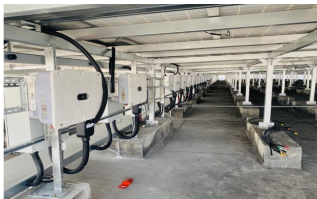
项目客户: 华为松山湖南方工厂C区C4楼栋 项目类型: 700kWp分布式光伏发电项目
