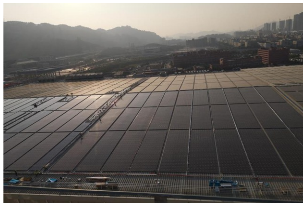
项目客户: 深圳华星T7玻璃厂二期2.7MWp 项目类型: 屋顶分布式光伏发电项目
