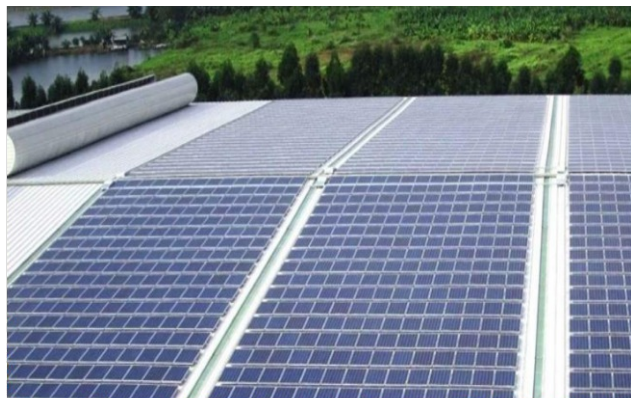
项目客户: 东莞南玻制造业厂房 项目类型: 10MWp分布式光伏电站
